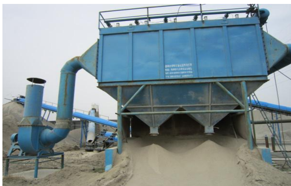
图 2-6 大型除尘设备
