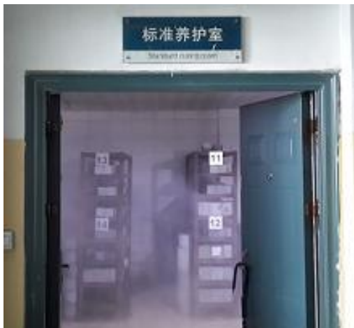
(c) 混凝土标准养护室
